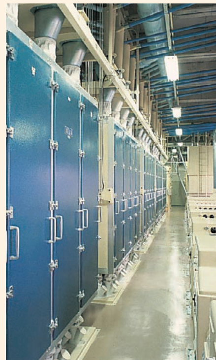
シフター・ピュリファイヤー室
